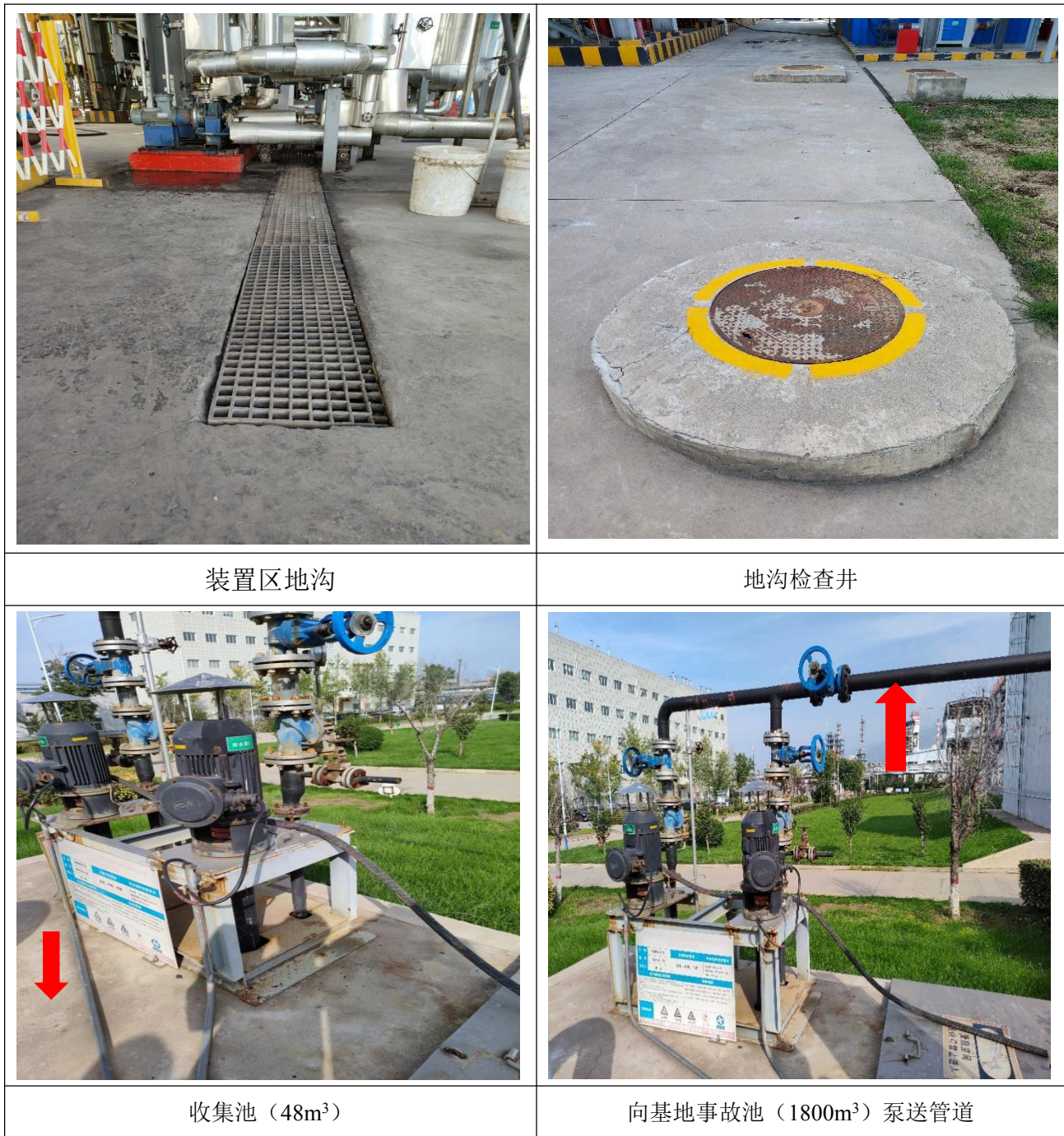
图 4-3 水污染防治设施现场照片
