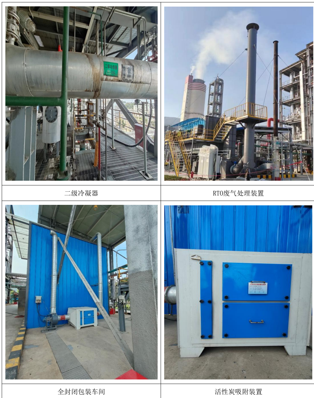
图 4-2 废气处理设施图
