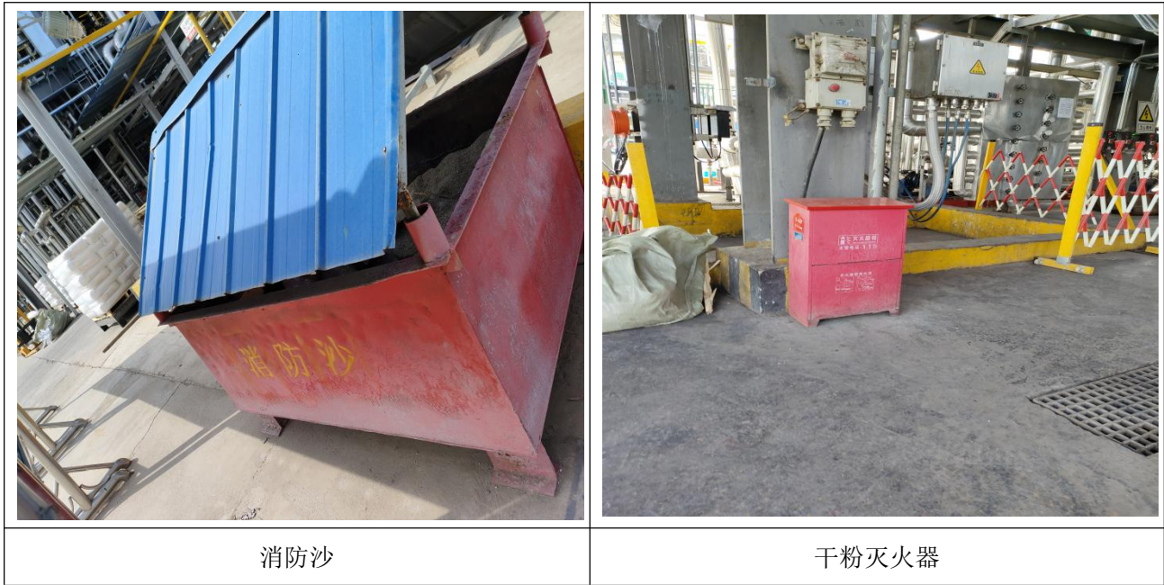
图4-6 消防设施现场照片
